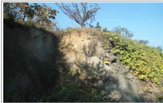
사면(중점부) STA.0+40 2단 숏크리트 탈락
