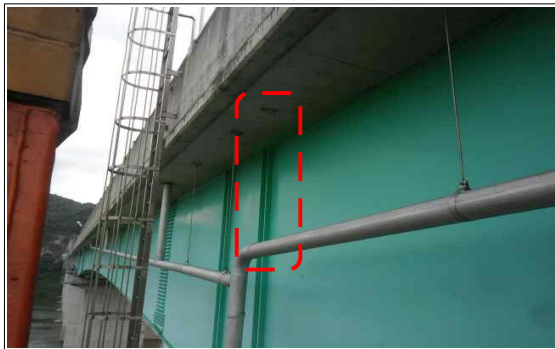
상행선 S9 배수관 연결재 및 연결고리 탈락
