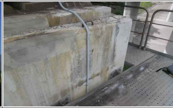
상행선 P21 코핑부 누수흔적(유도배수관 보수 완료)
