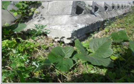
상행선 A2측 점검계단 하부 토사유실(공동 발생)
