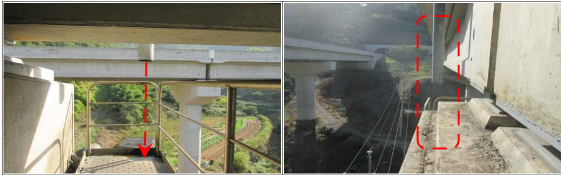
하행선 S2 배수관 유출구 위치불량(점검로 상부)
