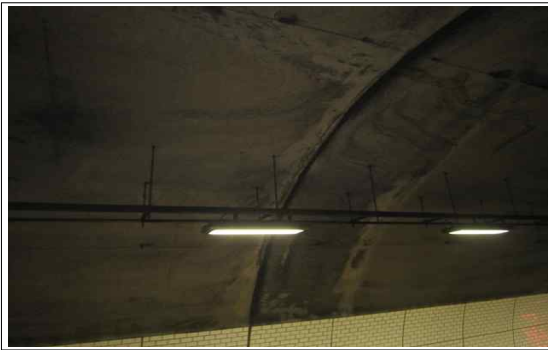
하행선 천정부 J38 콘크리트 들뜸 (A=0.1X3.0)
