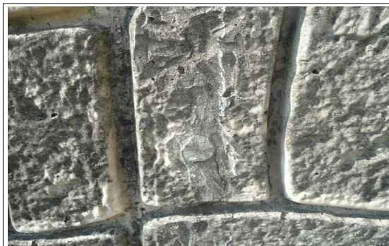
하행선 옹벽 시점부 균열
