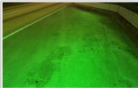
하행선 포장부 S154 균열
