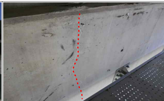
상행선 P15 코핑부 수직균열(폭 0.2mm)
