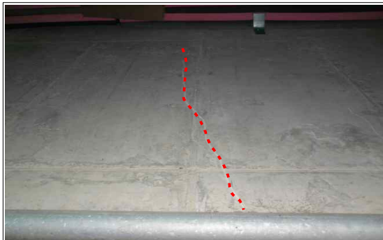
상행선 A2 교대 홍벽 수직균열(폭 0.2mm)
