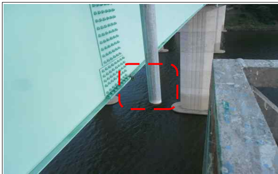
하행선 S4 배수관 수평지지대 탈락
