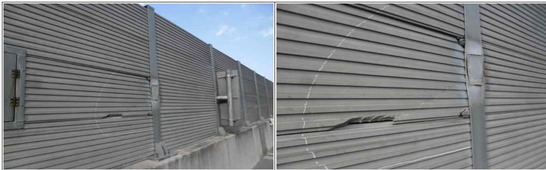
상행선 A1측 교량 시점부 방음벽 국부파손(차량충돌)
