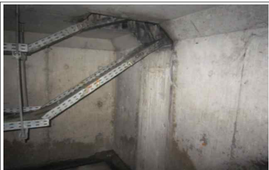
중점측 공동구내부 C면 공동구 연결홀 누수 (STA.0+0)
