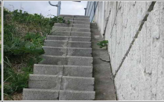
하행선 A2측 점검계단 파손
