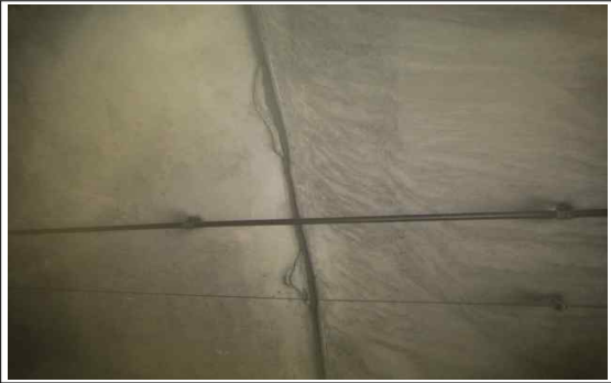
상행선 천정부 J39 콘크리트 들뜸 (A=0.3X0.3X3EA)
