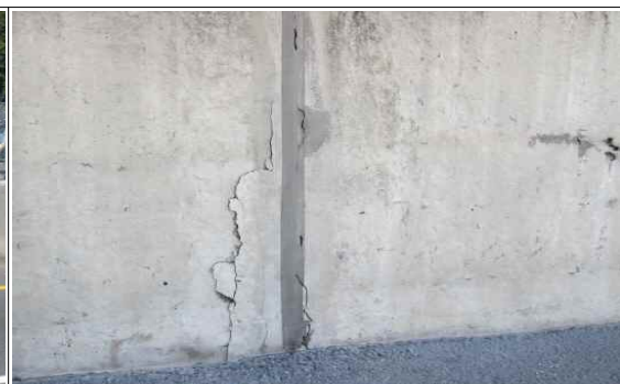
상행선 A2측 경계부 방호벽 콘크리트 들뜸
