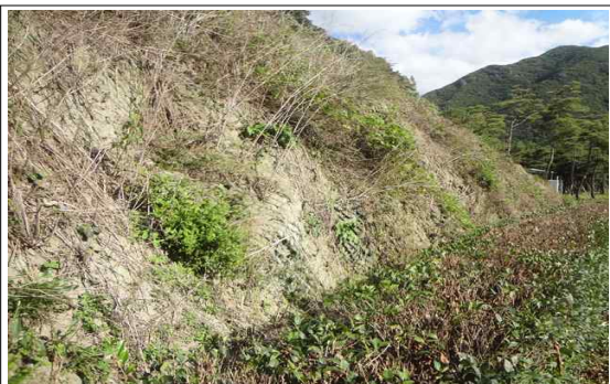
사면(시점부) STA.0+20 1단 녹생토유실
