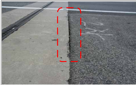
상행선 A2 신축이음 후타재 접속부 이격 및 단차
