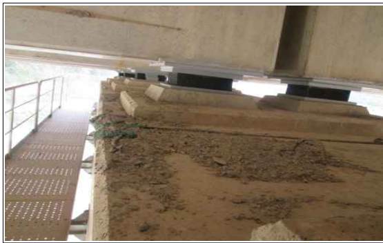
하행선 P3 코핑부 상면 이물질퇴적(폐콘크리트)
