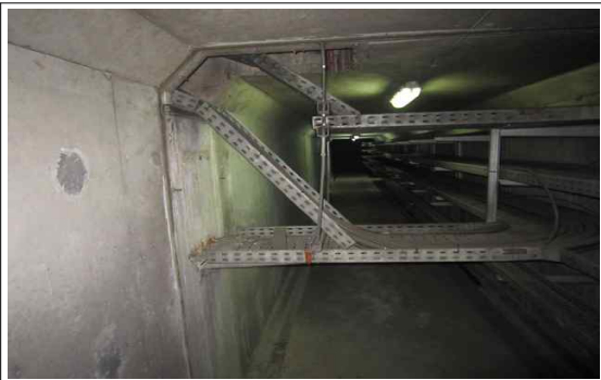
중점측 공동구내부 B면 공동구 연결홀 누수 (STA.0+20)
