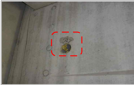
하행선 S24 G4(A2측) 주형외부 인양홀 주위 콘크리트 파손
