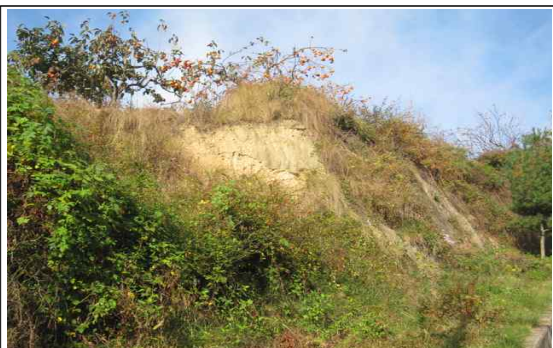
사면(시점부-하행) STA.0+90 1단 숯크리트 파손 및 표층유실
