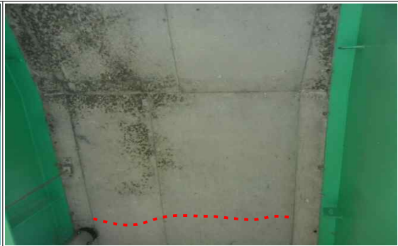
S3 바닥판 하면 횡방향 균열(폭 0.2mm)
