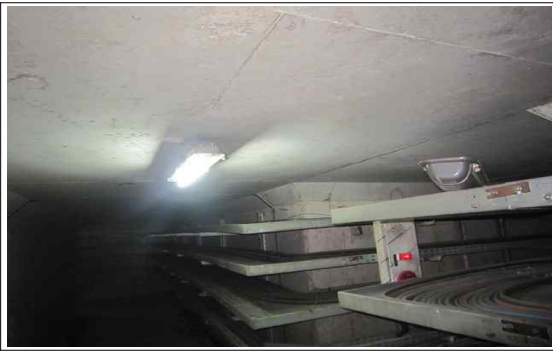
중점측 공동구내부 B면 천정부 등 덮개 탈락 (STA.0+10)
