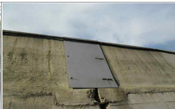
하행선 A2 차수판 볼트 탈락
