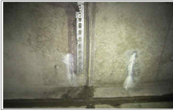
중점측 공동구내부 A면 우측벽 백태 (STA.0+25)
