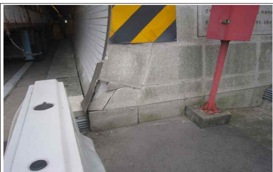
하행선 갭문 종점부 파손
