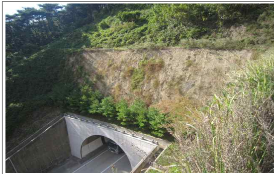
사면(시점부) STA.0+100 1단 녹생토유실
