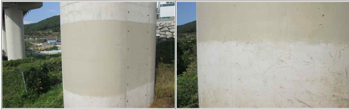
상행선 P1 기둥부 기존 망상균열 보수(하부 일부 구간 미보수 : 망상균열)
