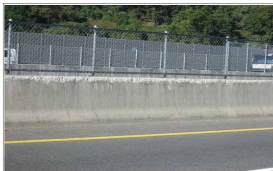
상행선 S13 방호벽 콘크리트 파손(차량충돌)
