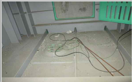
S1 주형내부 이물질 퇴적(전선 폐자재)
