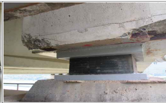
상행선 S21 G5(P3측) 주형외부 지점부 콘크리트 파손
