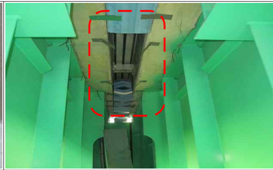
상·하행선 P12 신축이음 본체 하부 흡음재 탈락
