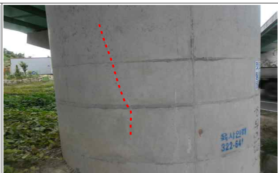
상행선 P1 기둥부 정면 보수부 재균열(폭 0.2mm)
