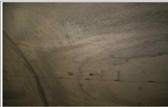
하행선 천정부 S139 균열 (폭 0.3mm)
