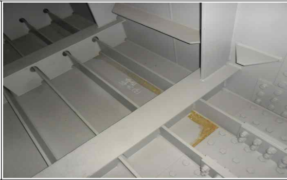
하행선 S13 G2 주형 내부 Split Plate 주위 우수유입 흔적
