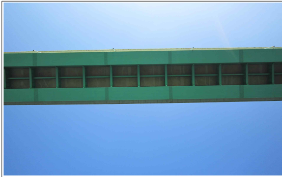
바닥판 하면 균열보수 현황
