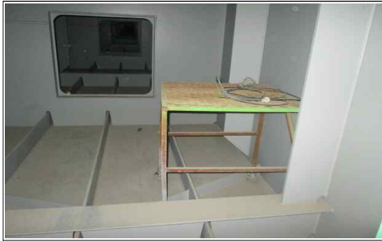
하행선 S12 G1 주형 내부 이물질 적치(공사 작업대)
