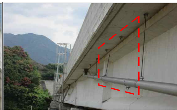
상행선 S13 배수관 연결재 탈락
