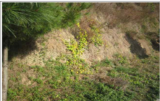
사면(시점부-하행) STA.0+70 1단 녹생토유실
