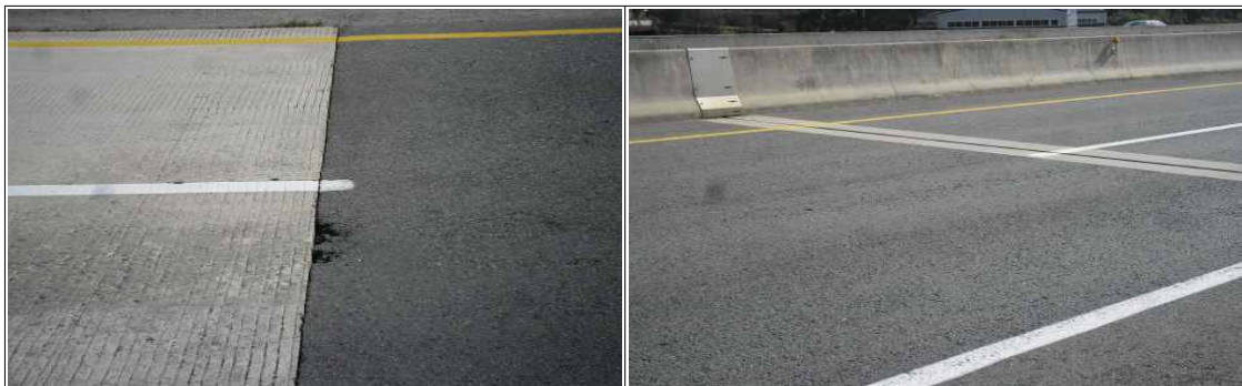
하행선 A2측 교량 종점부 교면포장 패임
