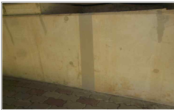
상행선 A2 교대 벽면 기준 균열보수(양호)
