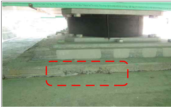
하행선 P1 SH2 받침콘크리트 재료분리
