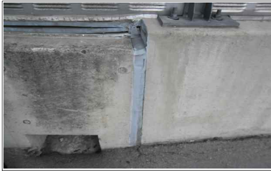
상행선 A2측 교량 종점부 방호벽 단차(약 14cm : 진전 없음)
