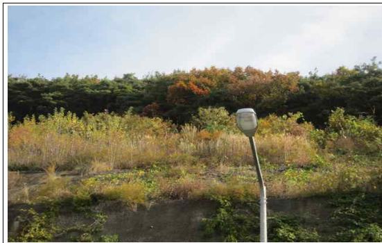
사면(시점부-상행) STA.0+90 3단 표층유실
