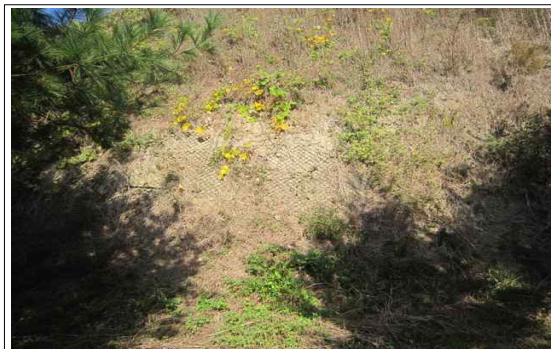
사면(시점부-상행) STA.0+180 1단 녹생토유실
