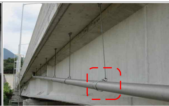
상행선 S5 배수관 연결고리 고정볼트 탈락
