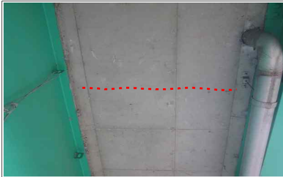
S1 바닥판 하면 횡방향 균열(폭 0.3mm)
