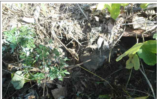
사면(중점부) STA.0+260 배수로 상부 낙석적치
