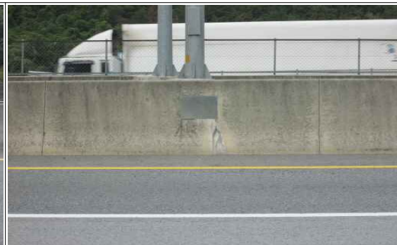
하행선 S1 방호벽 균열부 백태
