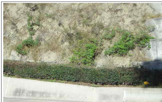
사면(시점부) STA.0+70 1단 녹생토유실
