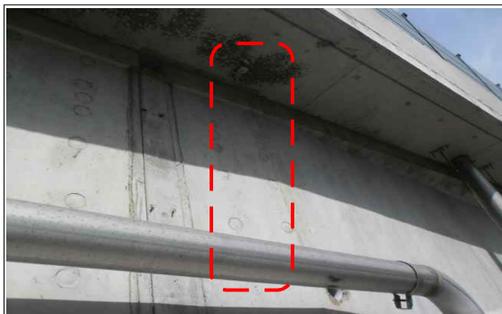
하행선 S17 배수관 연결재 탈락
