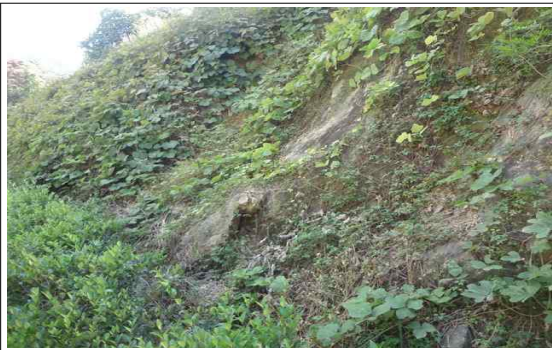
사면(시점부) STA.0+170 1단 표층유실 및 암노출
