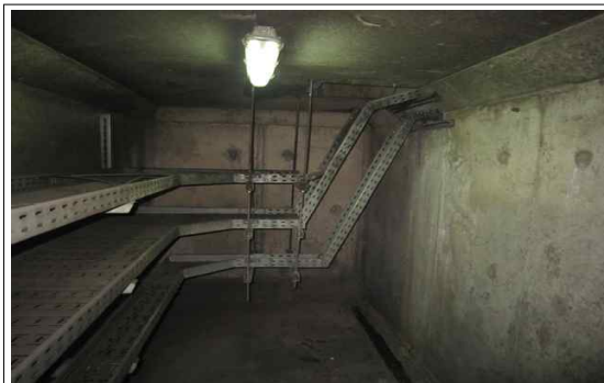
중점측 공동구내부 B면 공동구 연결홀 누수 (STA.0+30)
