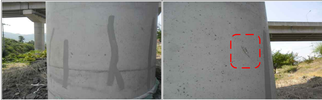
상행선 P3 기둥부 기존 균열보수
