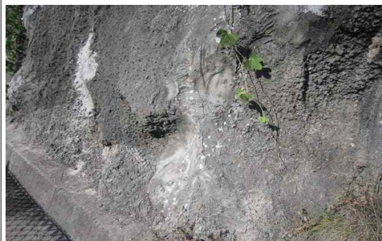
2단 슛크리트 균열 (26.99K 지점)
