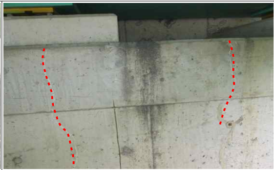
하행선 A2 교대 벽체 보수부 재균열(폭 0.1~0.2mm)
