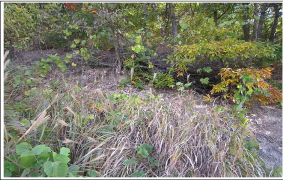
사면(시점부-상행) STA.0+80 자연사면 표층유실
