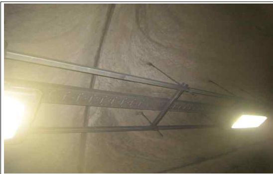
하행선 천정부 J49 콘크리트 들뜸 (A=0.1X0.5)
