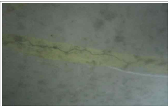
시점측 공동구내부 A면 천정부 전구간 재균열 (폭 0.1~0.2mm)
