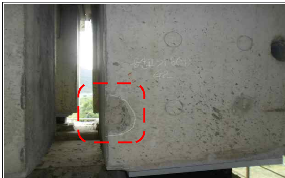
하행선 S16 G2(P15측) 주형외부 콘크리트 파손
