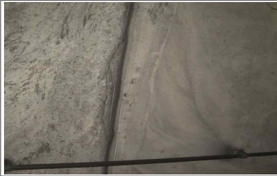
상행선 천정부 J30 콘크리트 들뜸 (A=0.2X0.4)
