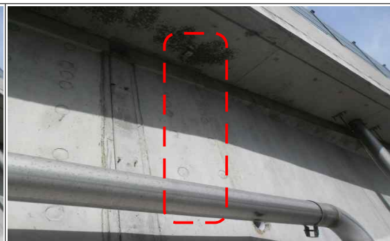
하행선 S24 배수관 연결재 탈락
