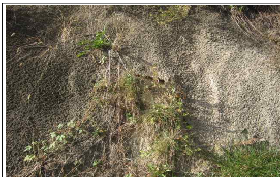
사면(시점부-하행) STA.0+80 1단 숯크리트 파손
