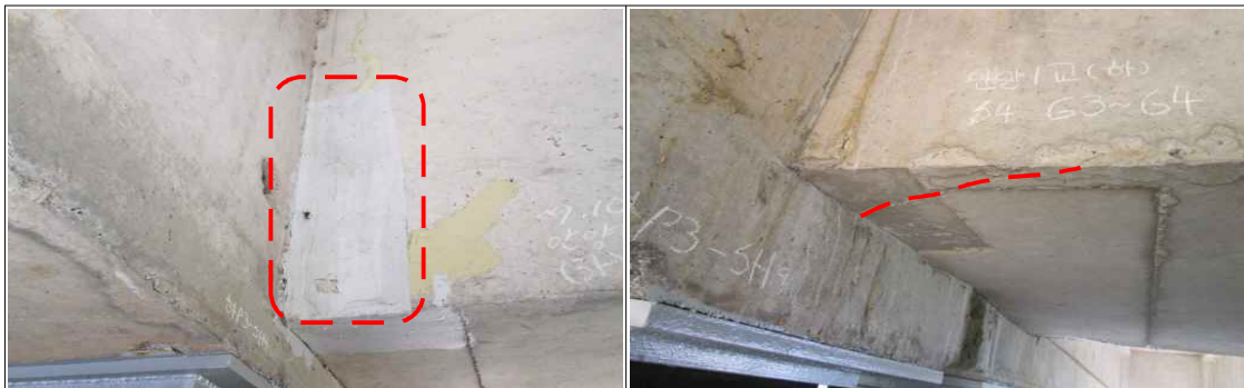
하행선 S3 G4~G5 가로보 측면 보수부 재손상
