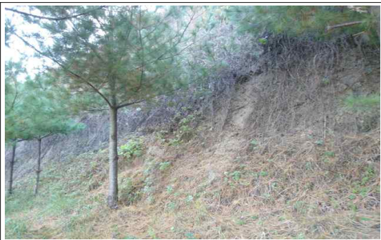
사면(중점부) STA.0+80~90 2단 녹생토유실
