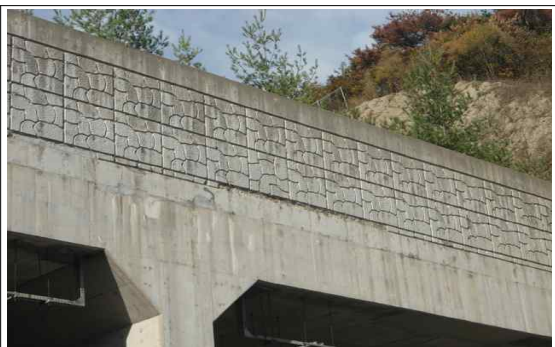
시점부 갭문 상행선 문양콘크리트 박락
