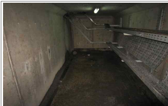
중점측 공동구내부 C면 공동구 연결홀 누수 (STA.0+15)
