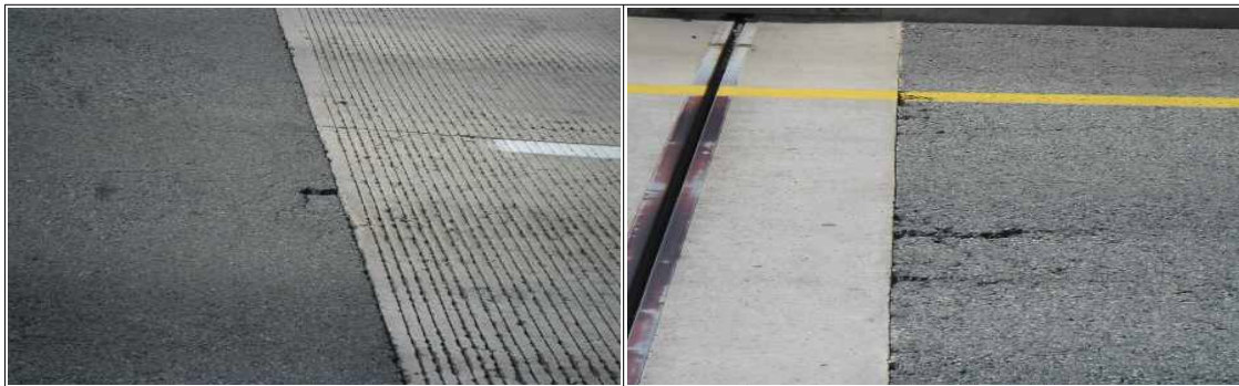
상행선 A2측 교량 종점부 교면포장 패임
