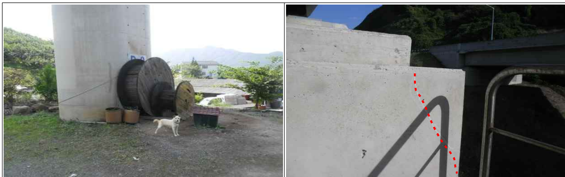
하행선하행선 P2 기둥부 이물질 적치
