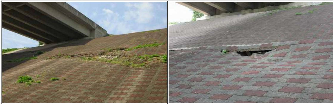
A2측 법면 침하 및 밀림, 파손
