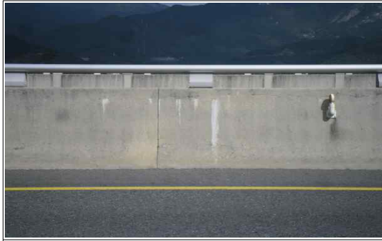
하행선 S5 방호벽 균열부 백태
