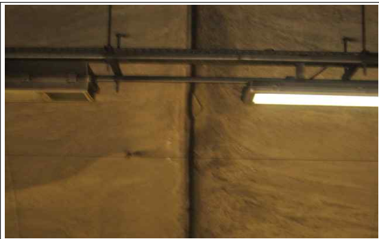
하행선 천정부 S202 콘크리트 들뜸 (A=0.1X0.3)
