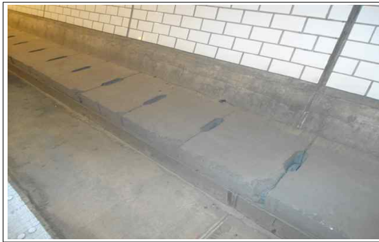
하행선 공동구 S17 덮개파손
