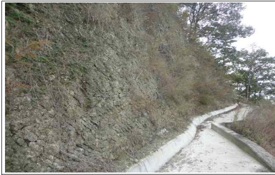
사면(중점부) STA.0+40 1~2단 녹생토유실
