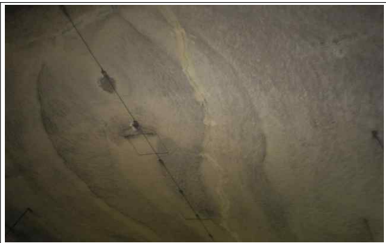
상행선 천정부 S74 재균열 (폭 0.5mm)
