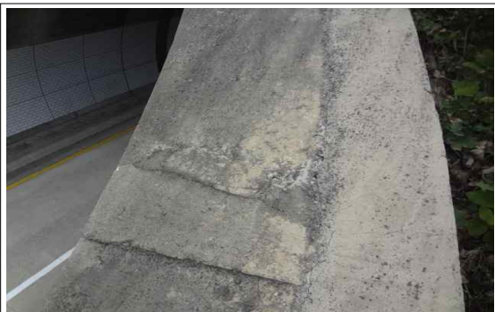
사면(시점부) STA.0+10 1단 갯문 균열
