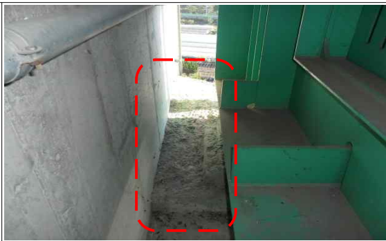
상행선 A2 교대 상면 홍벽 하부 마감처리 불량 (페콘크리트 퇴적)
