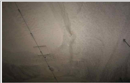
상행선 천정부 S37 재균열 (폭 0.3mm)
