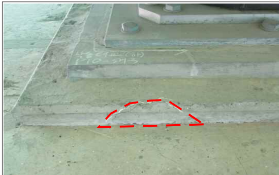
하행선 P10 SH3 받침콘크리트 들뜸
