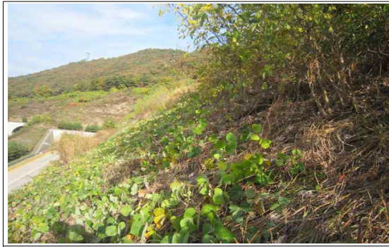
사면(시점부-상행) STA.0+80 3단 표층유실
