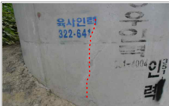
상행선 P1 기둥부 우측면 보수부 재균열(폭 0.2mm)
