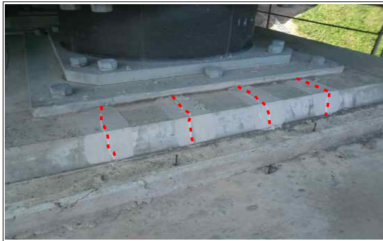
상행선 P14 SH4 보수부 재균열(폭 0.1mm)
