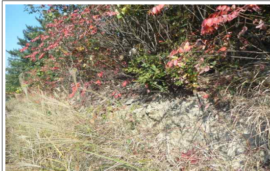
사면(중점부) STA.0+180 자연사면 표층유실
