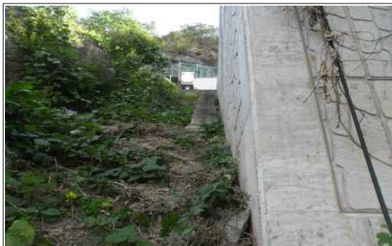
상행선 A1측 점검계단 일부 구간 계단 미설치
