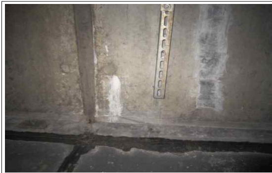
중점측 공동구내부 B면 좌측벽 백태 (STA.0+15)
