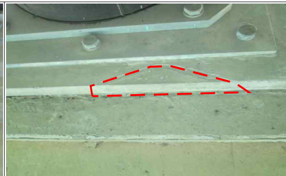
하행선 P10 SH3 무수축물탈 균열
