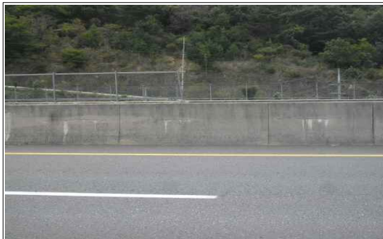
상행선 S3 방호벽 균열부 백태
