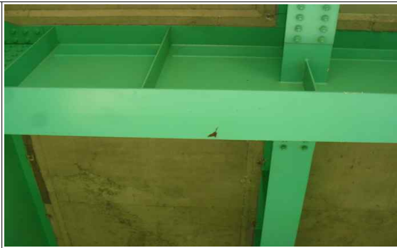
하행선 S5 가로보 국부적인 도장손상
