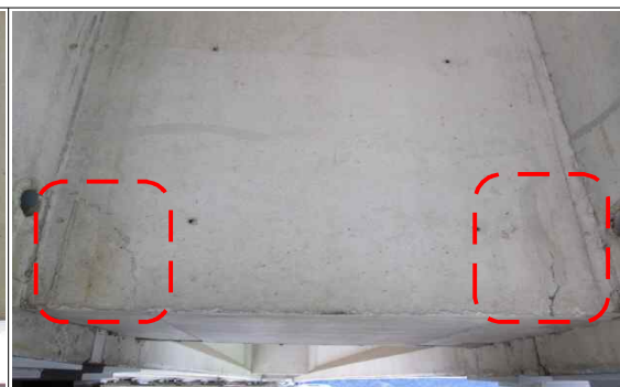
하행선 S12 G1~G2 가로보 콘크리트 들뜸
