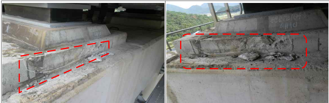
상행선 P21 SH10 기존 받침콘크리트 들뜸부위 파손
