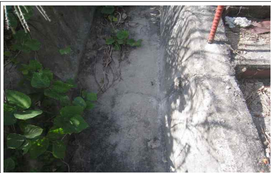
산마루측구 균열 (26.95K 지점)
