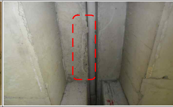
하행선 S22 바닥판 하면 신축이음 하부 콘크리트 파손
