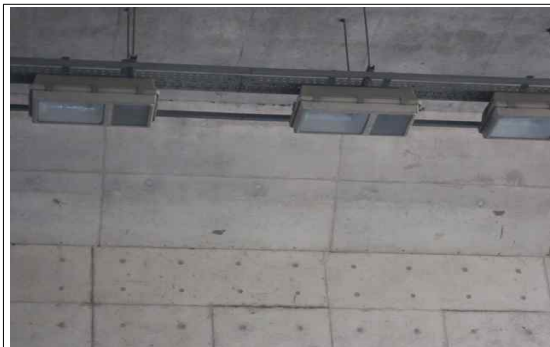
상행선 슬래브하면 S7 균열 CW=0.1mm
