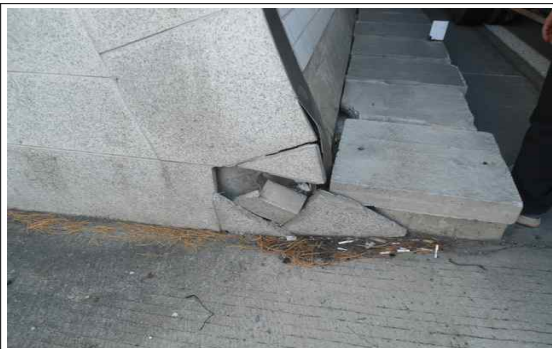
상행선 갭문 종점부 대리석 파손
