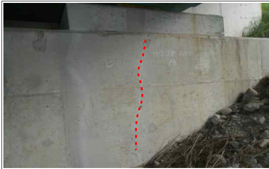
상행선 A2 교대 벽체 보수부 재균열(폭 0.1mm)
