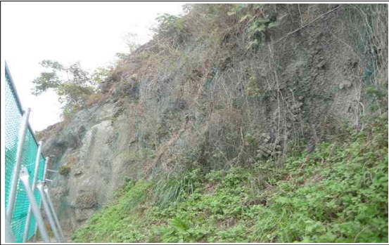
사면(중점부) STA.0+50~60 1단 녹생토유실
