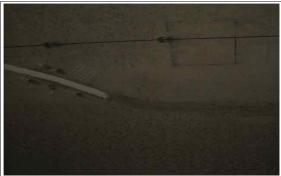
상행선 천정부 S108 균열 보수 및 재균열
