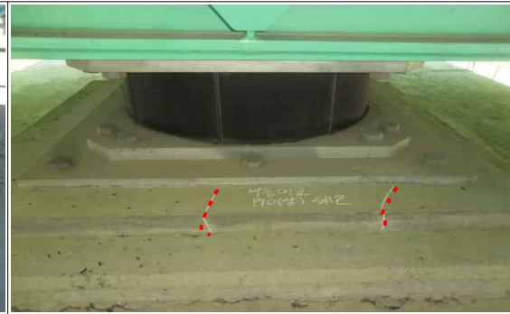
상행선 P10 SH2 무수축물탈 균열(폭 0.1mm)
